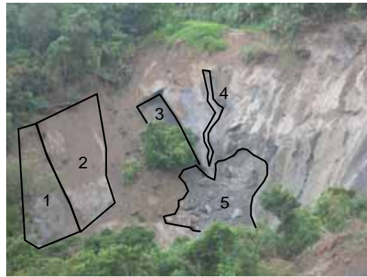
写真 - 6 滑落崖に見られた北傾斜の平滑面(1,2,3,4)と滑落崖からの崩落土岩(5)(6月13日午前10時頃撮影)
